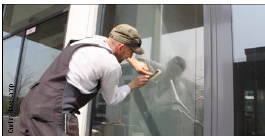
Monteur bei der Beschichtung: Die Klimaanlage erreicht ihre Soll-Werte dank Energiesparfolie schneller.
